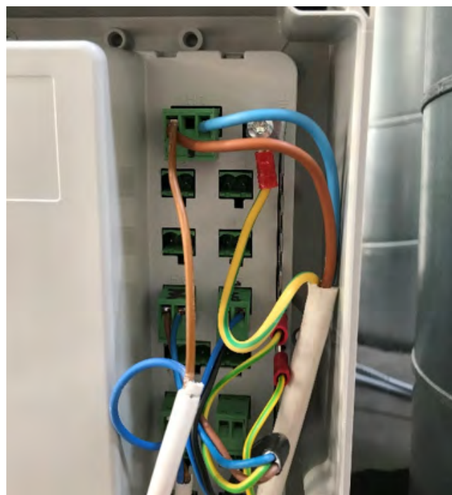
Figur 5: Strømforsyningsboks til ventilationsanlæg
